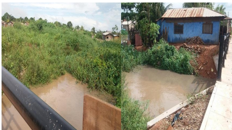
Figura 45. Estación III-2 del caño natural "Unión", luego de una lluvia moderada. Pucallpa, 2018.
